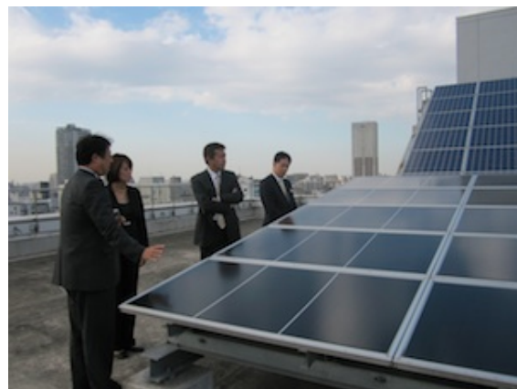
屋上に設置された太陽光パネル (千住テクノステーション)
