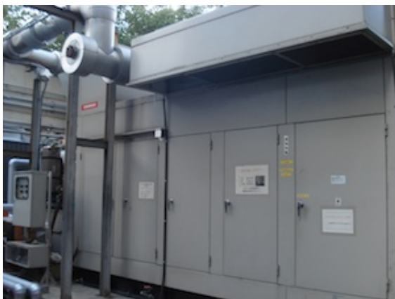
ガスエンジンコージェネレーション 370kW
