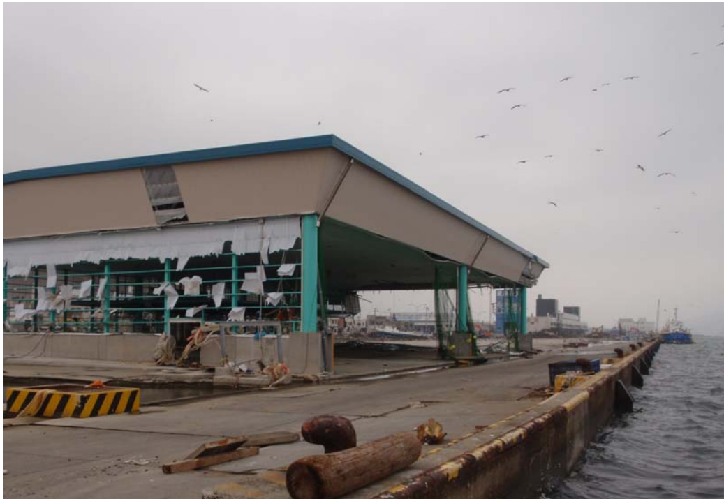
石巻漁港の様子(長さ 652m もの上屋根のあった魚市場付近。津波被害を受け、解体・撤去が進む)
