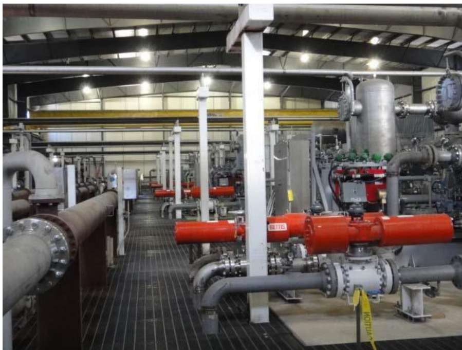
出典：DOE ホームページより：イリノイ州の商用 CCS プロジェクトの CO 2 圧入設備
