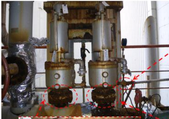
スチームコンバータバイパス管安全弁
